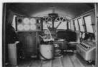
Schaltkasten, Turbo-Wechselrichter, Verteilerkasten, Regel- transformator, Tonbandgerät, Plattenspieler, Handmikrofon Switchboard, turbo-rectifier, distribution panel, variable trans- former, tape recorder, record player and hand microphone Tableau de commande, Turbo-redresseur, boîte de distribution, transformateur réglable, magnétophone, tourne-disque, microphone portable Cuadro de mando, turbo-rectificador, caja de distribución, transformador reductor-elevador, magnetófono, tocadiscos, micrófono portátil Quadro di comando, turboconvertitore, cassette di distribuzione, trasformatore a regolazione, magnetofono, giradischi, microfono portatile
