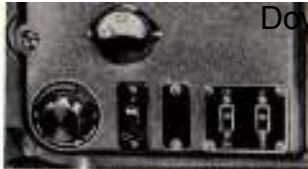
Schalteneinrichtung auf der Bedienungsseite
